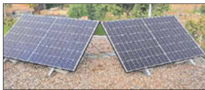
Photovoltaik-Anlage auf Garagendach
